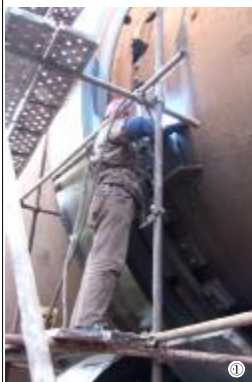
2月25日,氧化铝一厂3号熟料窑2档托轮托板受力被顶掉,部分筒体裂毁,严重影响设备的安全稳定运行。工程司检修车间、管道车间、铆焊车间接到任务后,抽出精兵强将立即对设备进行了全面解体检修,尽管气温骤降,但广大参战员工克服重重困难,相互协作,配合默契,经过两昼夜的紧张抢修,确保了大窑一次试车成功。
