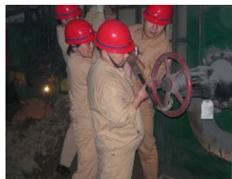
近日,热力厂1号至5号汽轮机发电机组水系统全面更新改造,确保了生产的安全运行。图为员工们正在合力关闭动力循环水阀门。张文斌 许颖洲 摄影报道
