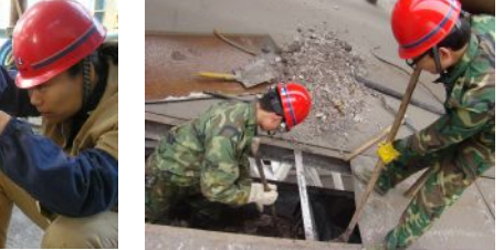
11月30日,氧化铝厂七车间分工序6名新员工对大蒸发室外原液泵房地沟积碳进行了彻底的清理,为安全生产打下了基础。 董爱东 摄影报道
