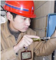
11月28日,水电厂对氧化铝一厂四车间主要生产设备的通信电视进行了大修改造。图为车间员工在安装新的分线盒。 陈文峰 摄影报道
