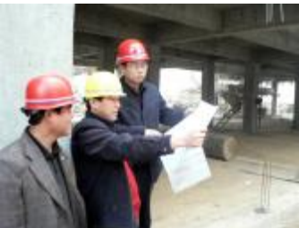
自2007年3月份开始,后勤服务管理中心开始对二十二街坊幼儿园1号楼进行拆除,并在原址上建造一座3867平方米的现代化多功能教学楼。新教学楼将于今年11月底进行主体工程竣工验收。建成后的长域幼儿园,将成为郑州市西部地区最具影响力的幼儿园之一。左图为工程技术人员正在现场研究工作。右图为即将落成的多功能教学楼。 马义林 摄影报道
