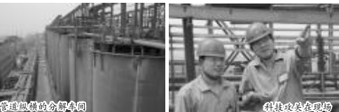
管道纵横的分解车间
