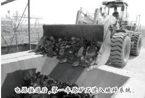
电源接通后,第一车原矿石进入破碎系统。
