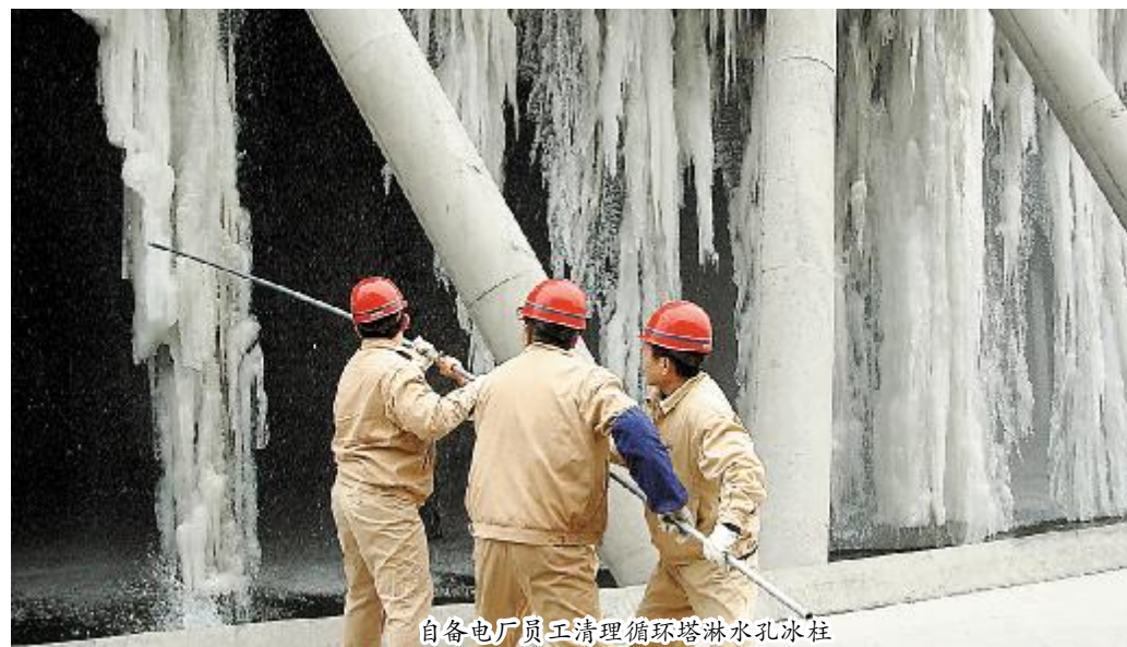
自备电厂员工清理循环塔淋水孔冰柱
