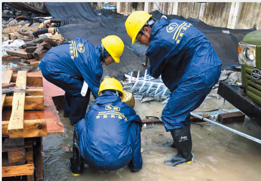
消防水管预留洞口出现雨水倒灌风险，项目部员工急忙用防水材料覆盖包裹
