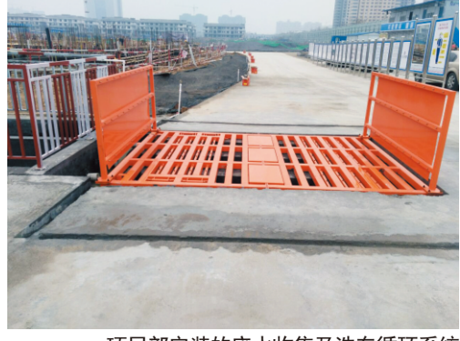
项目部安装的废水收集及洗车循环系统
