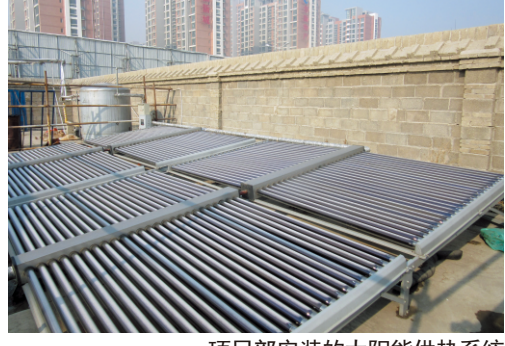
项目部安装的太阳能供热系统
