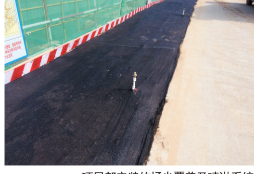
项目部安装的扬尘覆盖及喷淋系统
